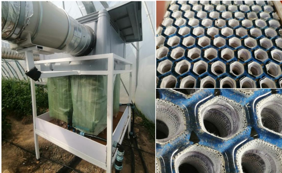
Figure 28. l'absorbeur installé dans le démonstrateur tunisien (à gauche) et la structure interne de l'absorbeur pour la distribution du TCF sur la surface de contact (à droite).
