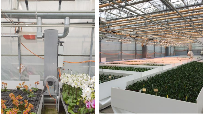
Figure 53. L'unité d'absorption (à gauche) et les tables de plantation (à droite) dans la serre en Suisse.
