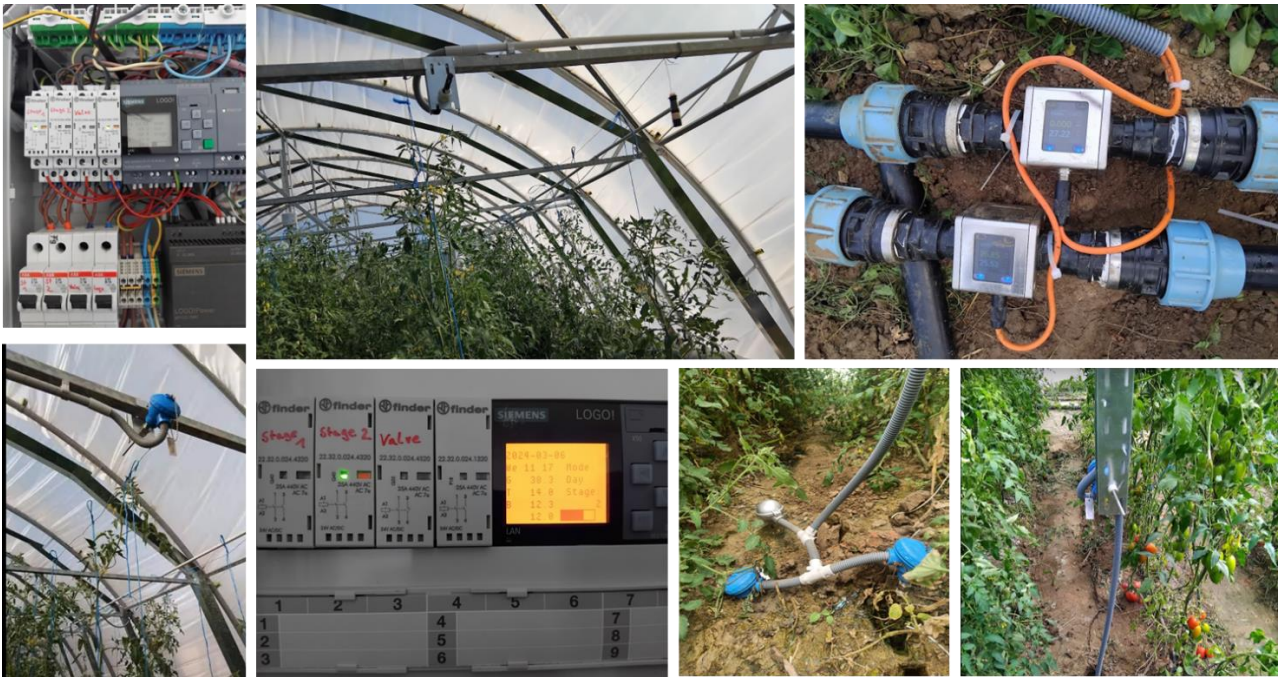
Figure 36. Installation du boîtier électrique, des capteurs et du système d'acquisition de données.
