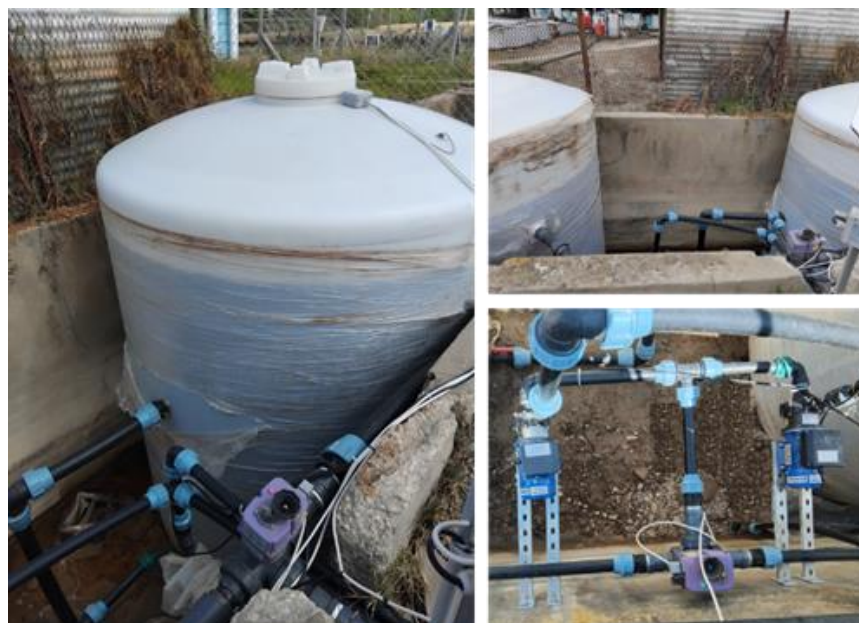
Figure 34. Pompes et électrovannes sur le réservoir de stockage.
