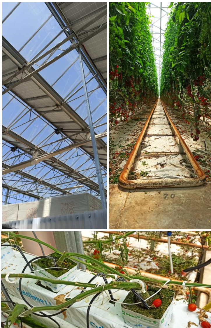
Rys. 54. Szklarnia Sfera Agricola – system dachowy (u góry po lewej), system ogrzewania rurowego (u góry po prawej) i rośliny pomidorów z czujnikami (u dołu).
