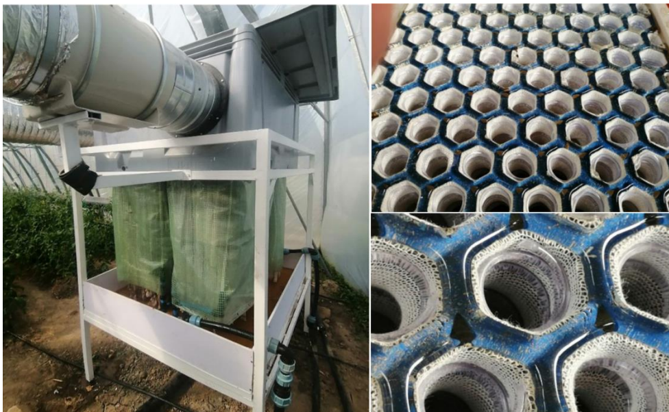
Figura 28. El absorbedor instalado en el demostrador tunecino (izquierda) y la estructura interior del absorbedor (derecha).
