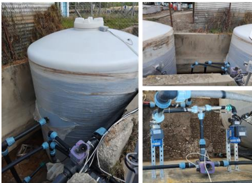
Figura 34. Bombas y electroválvulas.
