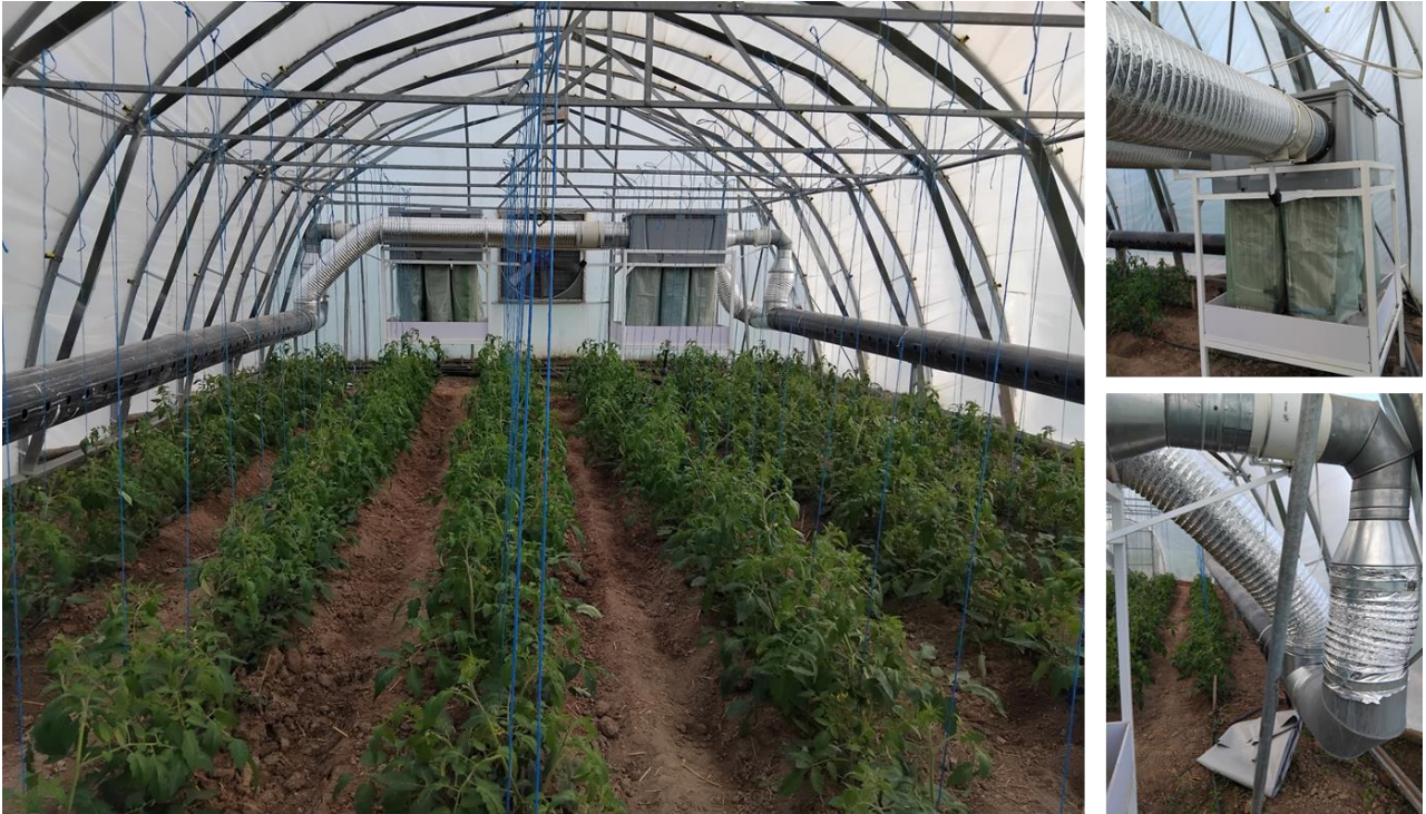
Rys. 35. Instalacja urządzeń pochłaniających i systemu cyrkulacji powietrza wewnątrz szklarni (wentylatory + kanały powietrzne).
